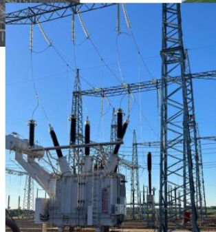
Subestación María Auxiliadora 220/23 kV
