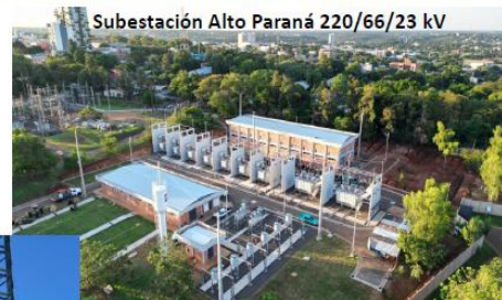
Subestación Alto Paraná 220/66/23 kV
